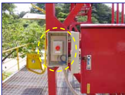
乗降場に設置の非常停止ボタン
