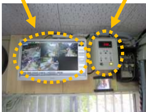
監視モニター及び風速表示機
