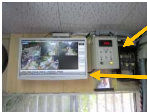
ふれあい広場駅の搬器監視装置及び風速監視装置
