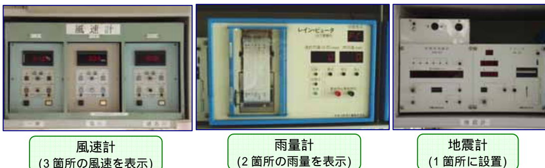
運転指令所に設置している各受信機
