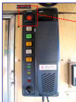
列車無線装置
