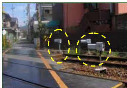
踏切障害物検知装置
