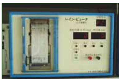
雨量計 (2箇所雨量を表示)
