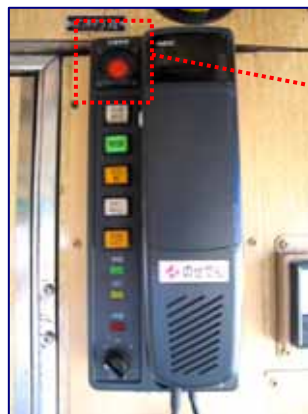
列車無線装置
