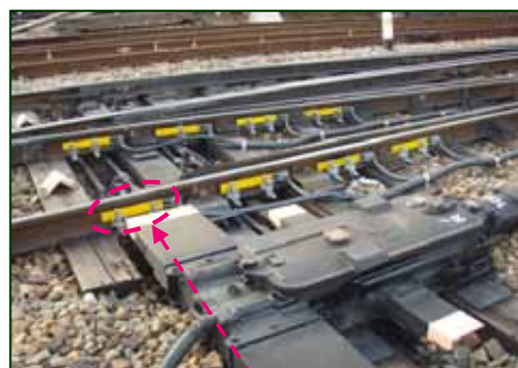
分岐器と電気融雪器ヒーター
