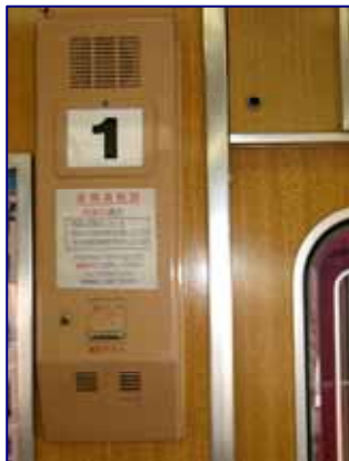
非常通話装置
