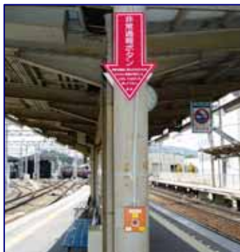
非常通報ボタン
