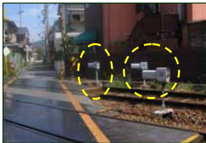
踏切障害物検知装置
