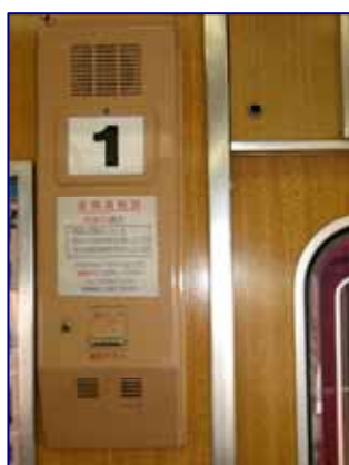
非常通話装置
