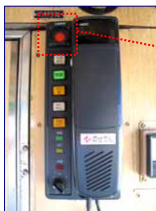
列車無線装置
