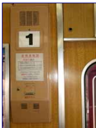
非常通話装置
