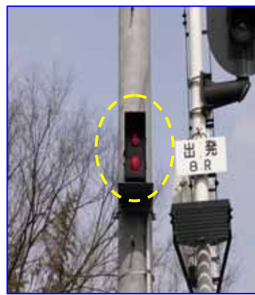
非常通報用アクシデントサイン
