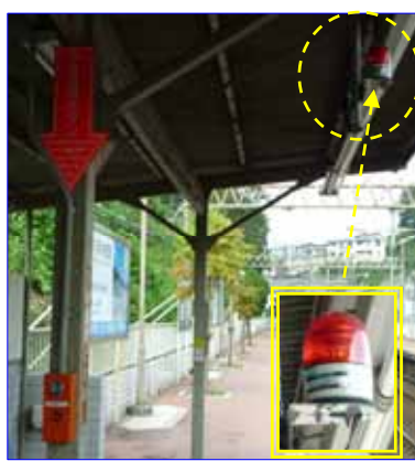
非常通報回転灯
