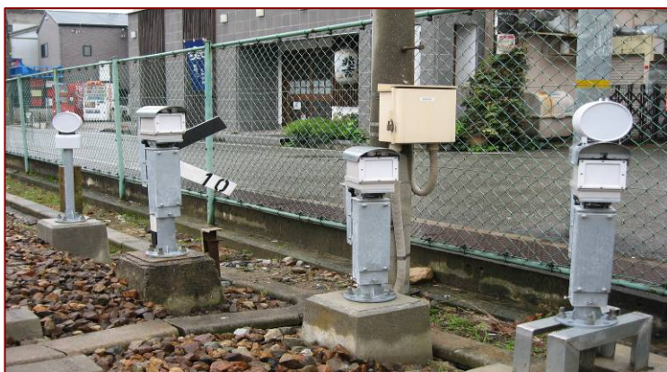
踏切障害物検知装置 ミリ波式踏切障害物検知装置
