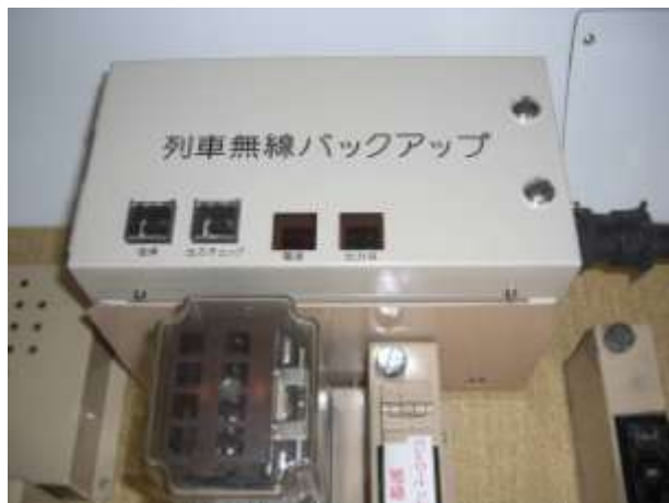
列車無線バックアップ装置
