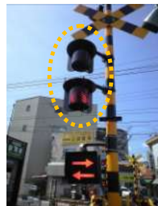
全方向踏切警報灯
