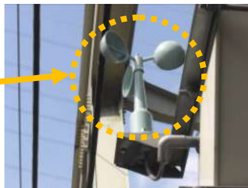
塩川橋梁に設置されている風速計
