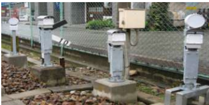
多田踏切道ミリ波式踏切障害物検知装置
