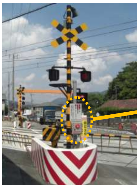
踏切非常通報装置
