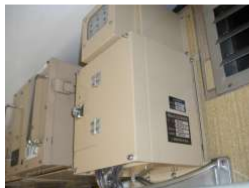
運転状況記録装置
