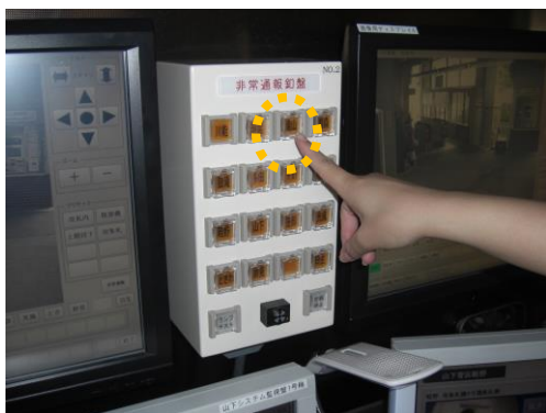
該当駅の非常通報ボタンを係員が押下。
