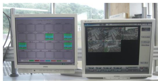
踏切集中監視装置
