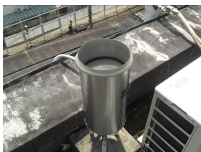
平野駅に設置されている雨量計
