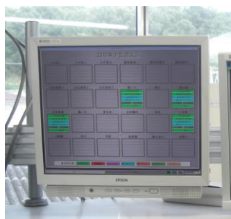
踏切集中監視装置 (踏切非常通報装置等の操作や障害物検知装置・遮断機未降下等の事象が発生した場合に警報が鳴動)
