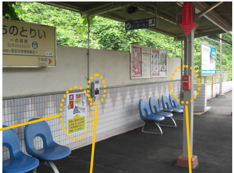
係員呼び出し用インターホン
