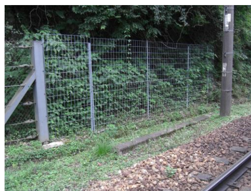
野生動物侵入防止用の金網ネット
