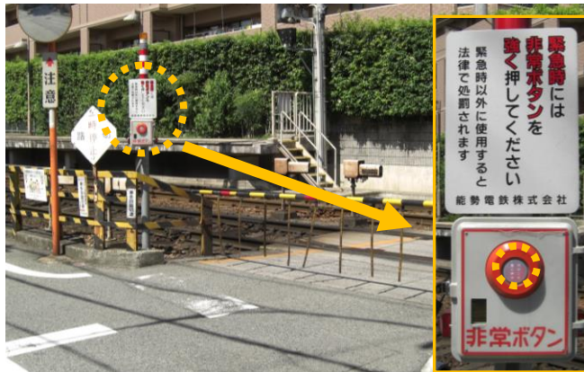
東多田踏切の踏切非常通報装置
