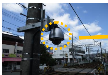
踏切監視カメラ
