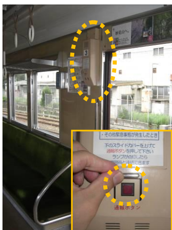
客室内の非常通話装置 （1700、3100 系）
