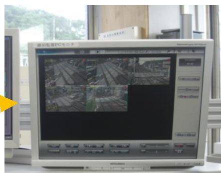
踏切監視モニター
