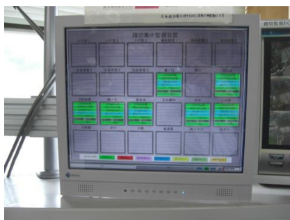
踏切集中監視装置
