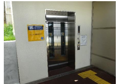
ときわ台駅エレベーター
