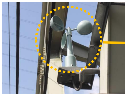
塩川橋梁に設置されている風速計
