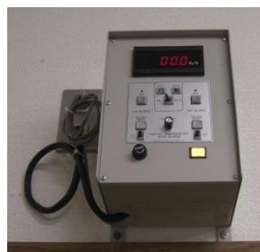
風速監視装置
