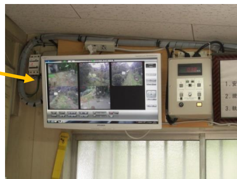
搬器監視モニター
