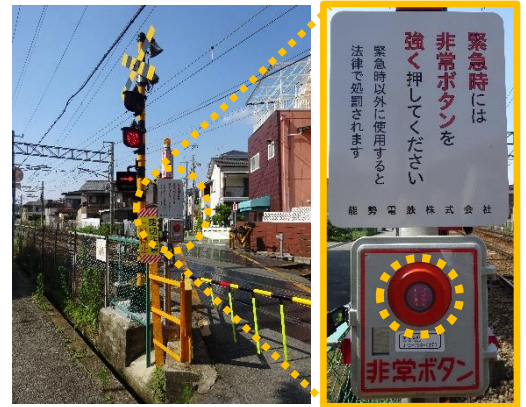
出在家第1踏切道の踏切非常通報装置
