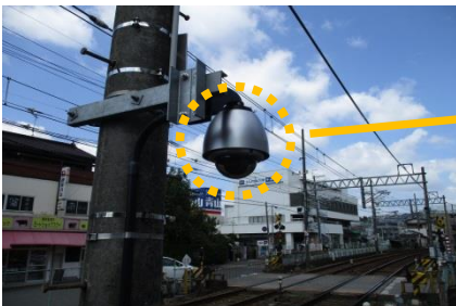
踏切監視カメラ
