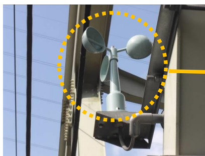
塩川橋梁に設置されている風速計
