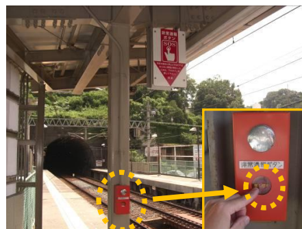
全駅に設置している非常通報ボタン
