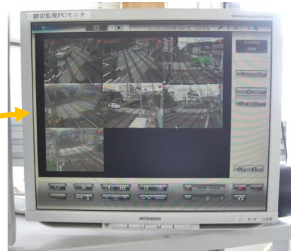
踏切監視モニター
