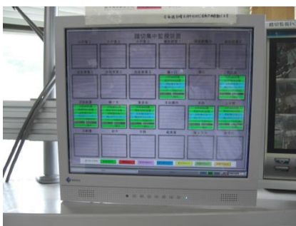
踏切集中監視装置
