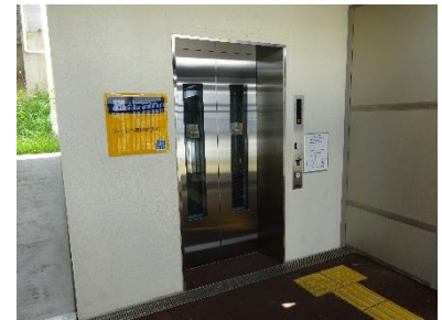
ときわ台駅エレベーター
