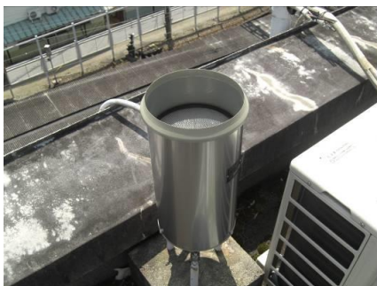
平野駅に設置されている雨量計
